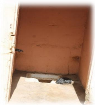
<図63 地方のトイレ-汲み取り式トイレすら数少ない>
